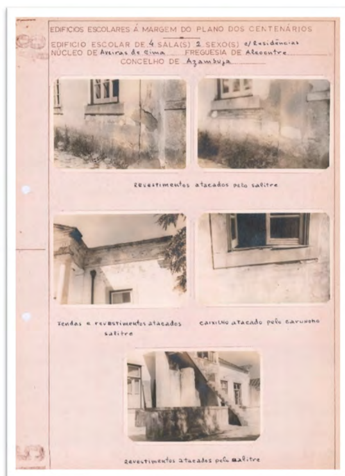
Aspetos da degradação do edifício escolar “tipo Grandella”, Aveiras de Cima, 1968 (I)
